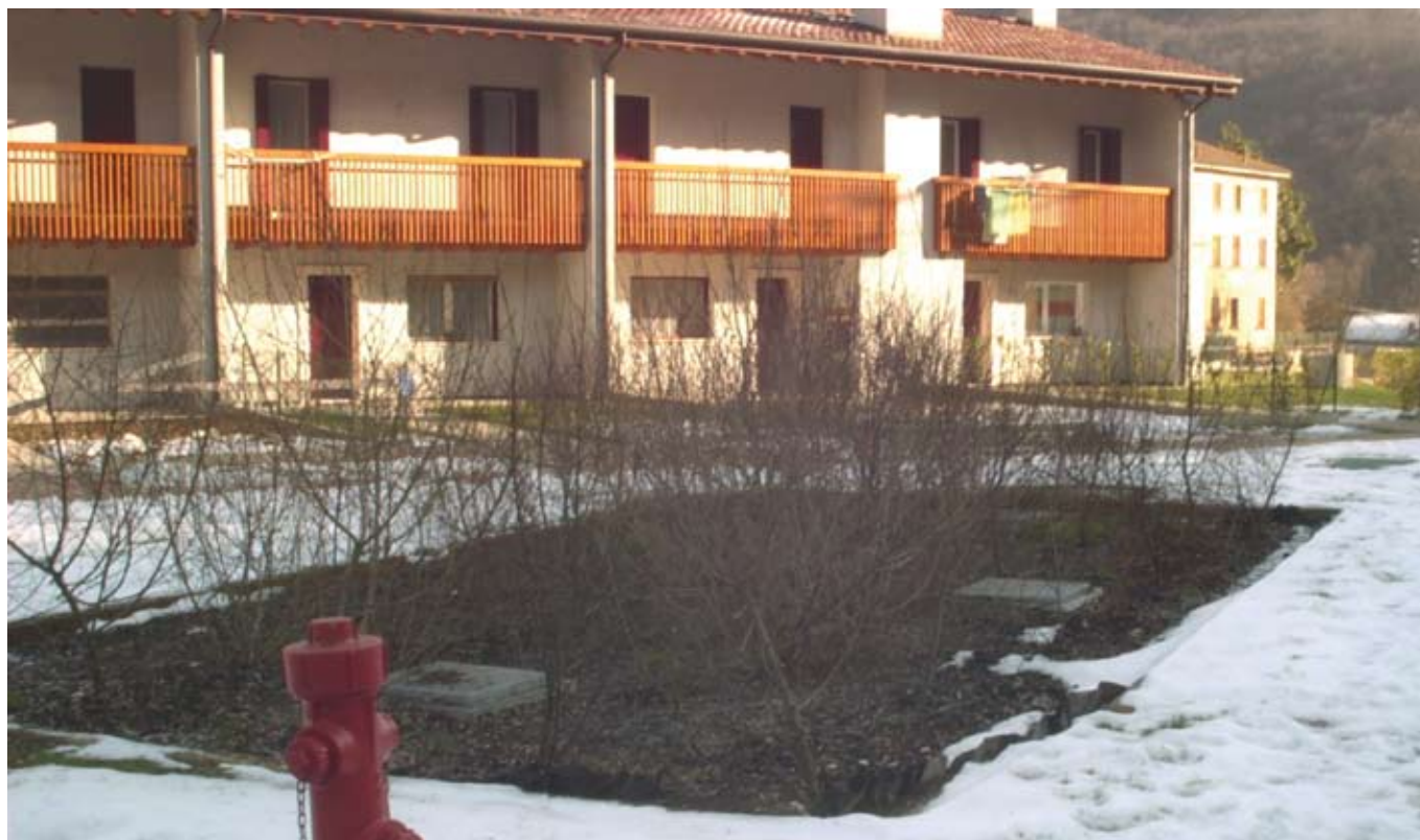
Impianto realizzato ad alta quota
