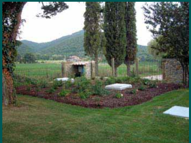
Impianto per 60 abitanti equivalenti
