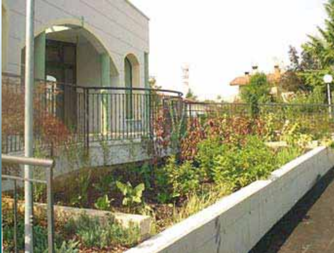
Impianto per 30 abitanti equivalenti
