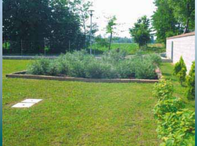
Impianto per 60 abitanti equivalenti
