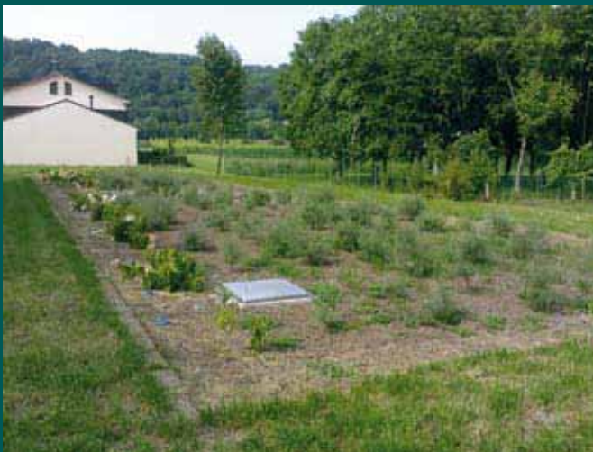
Impianto per 300 abitanti equivalenti
